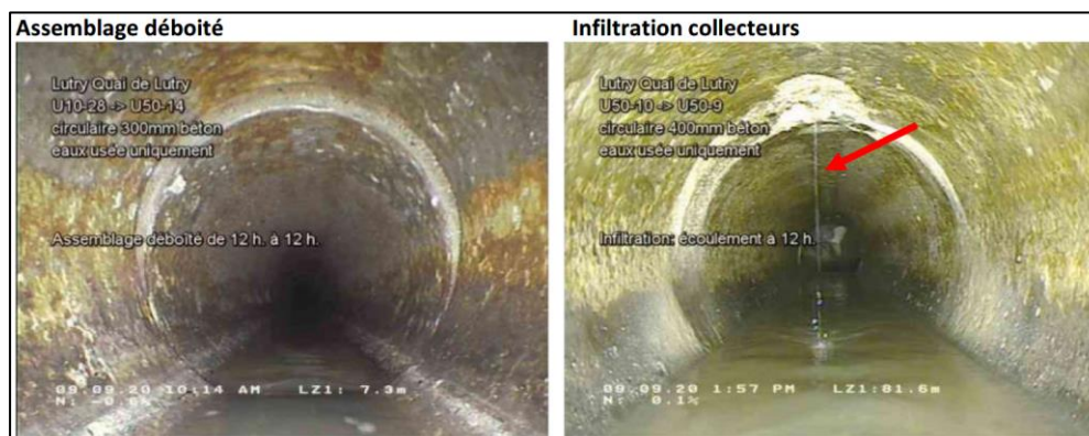
Figure 2 - Exemples de défauts d'étanchéité
