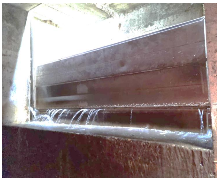
Figure 1 - Eau du lac pénétrant dans le collecteur
