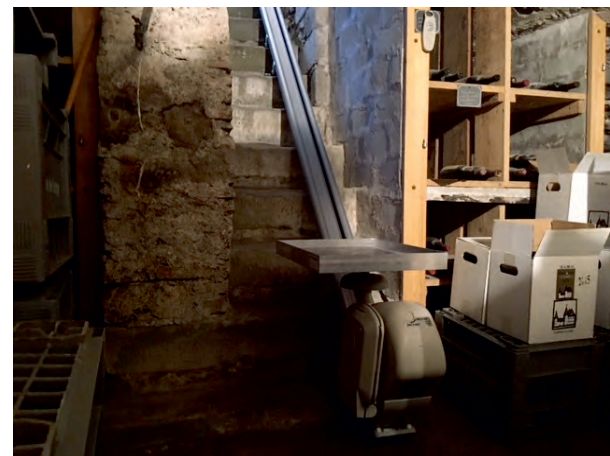
Château : monte-escaliers (cave)
