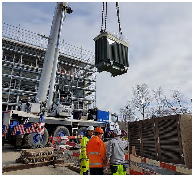
Transformateur de la sous-station du Vallon
