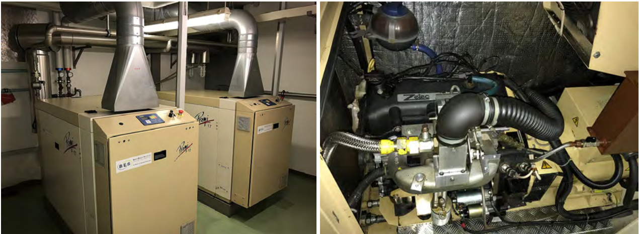
Photo des génératrices et de leurs moteurs à gaz
