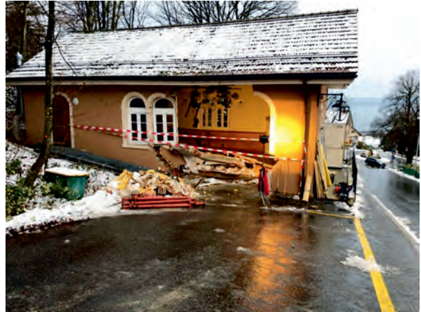
Salle d'Echerins (façade Nord): mur défoncé par un chasse-neige dans la nuit du 16 au 17 décembre 2017
