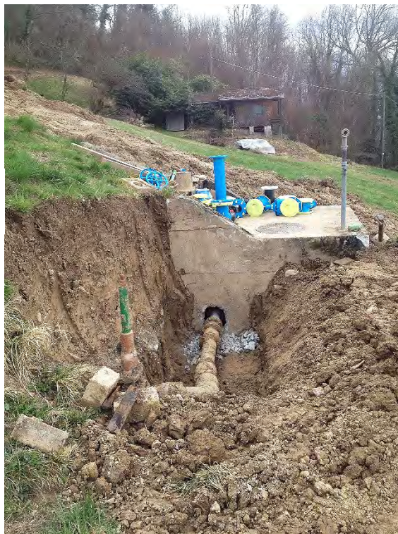
Chambre de réunion des alimentations en provenance de Pont-de-Pierre et du Pays-d'Enhaut
