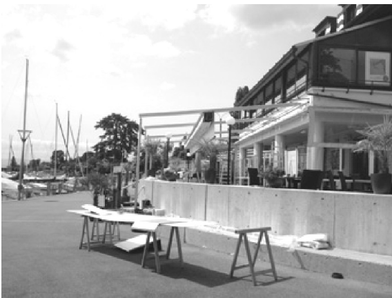
La Lagune – Store sur la terrasse
