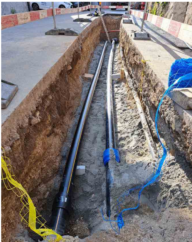
Route de Vevey, extension du réseau de gaz et remplacement de la conduite d'eau.
