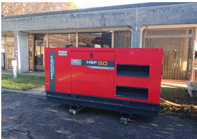
Génératrice installée à la STEP
