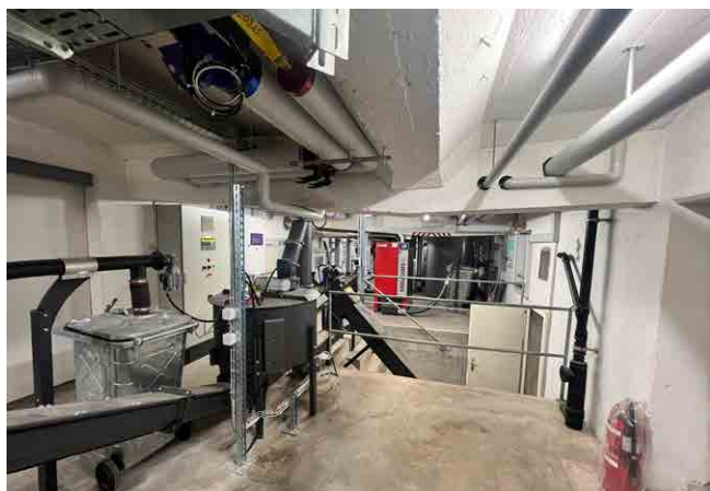
Mise aux normes et rénovation de la chaufferie du centre scolaire de La Croix/Lutry
