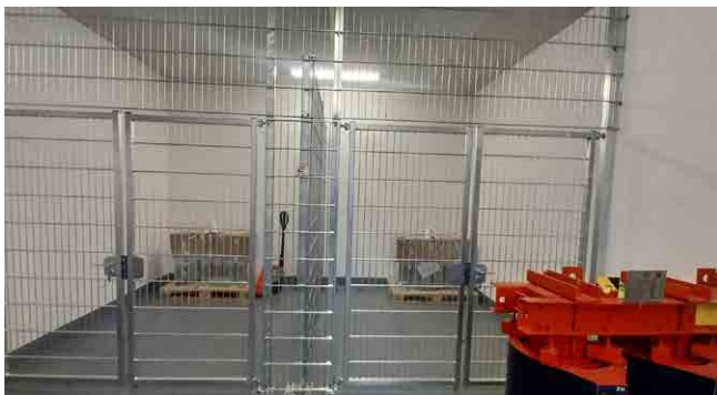
Poste Lutry, aménagement et réfection du local avant installation des nouvelles télécommandes.
