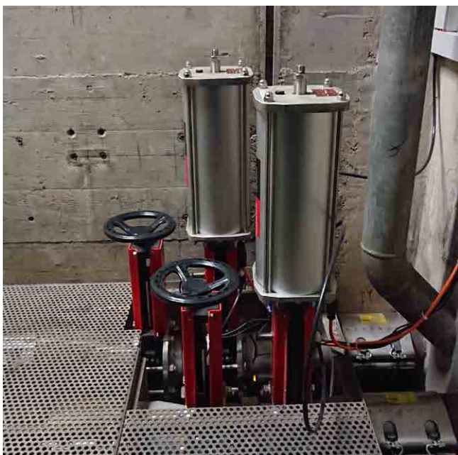
Nouvelles vannes à boues
