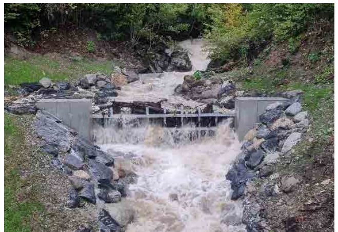
La nouvelle herse en fonction lors d'une forte crue de la Lutrive
