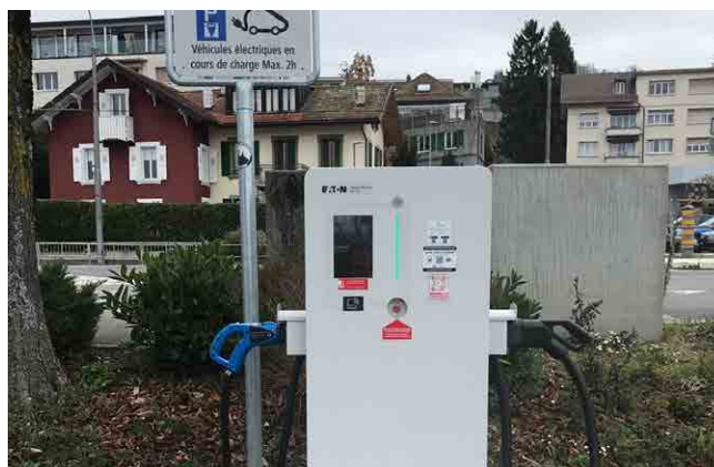
Borne DC d'une puissance de 44kW au parking du Vieux-Stand.
