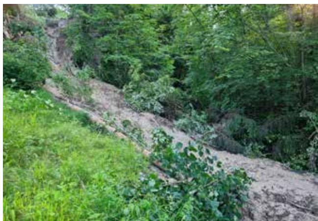
Glissement de terrain dans le ruisseau de la Lutrive
