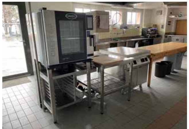
Remplacement de la cuisinière à gaz dans la cuisine de la salle du Grand-Pont
