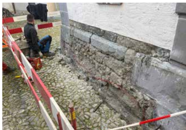
Assainissement des soubassements des murs de la cage d'escaliers principale du Château de Lutry.
