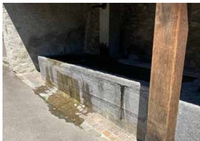
Fontaine de Corsy-Dessous avant les travaux d'étanchéité
