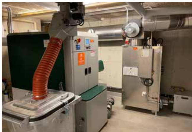
Remplacement de la chaudière à bois dans la chaufferie du centre scolaire de Corsy
