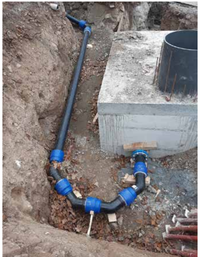
Chemin des Chênes, conduite de sortie chambre de réducteur
